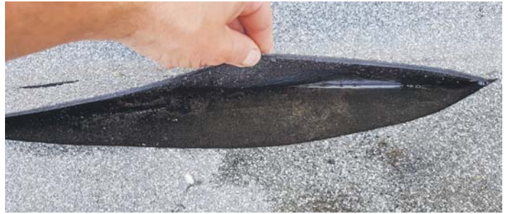
Kommen bei der Inspektion Schäden wie lose Dachbahnen zum Vorschein, ist eine schnelle Sanierung erforderlich, damit es im nächsten Winter im Haus trocken bleibt. Foto: djd/Triflex
